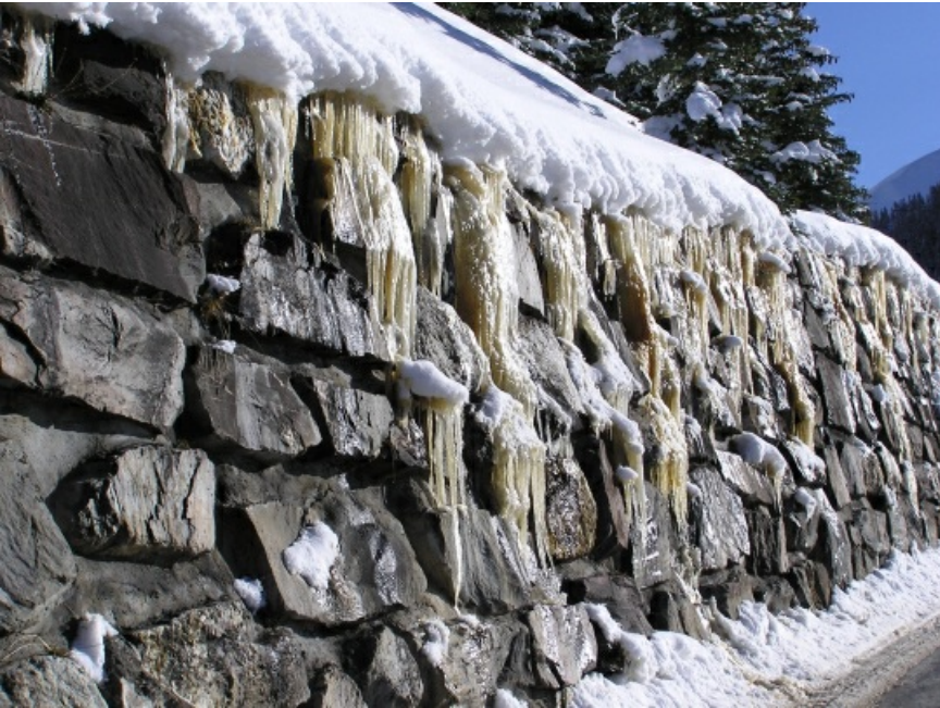
Die Ursache der vielen Gletschneerutsche und -lawinen wird hier sichtbar. Da der Boden vor dem Einschneien am Wochenende 10./11.11. noch relativ warm war, entstand in der Folge an der Schneedeckenbasis eine Schmelzschicht. Diese wirkt an glatten, sehr steilen Grashängen und Böschungen als Gleitschicht. Davos Monstein 1600 m), GR (Foto: SLF/C. Pielmeier, 18.11.2007).
