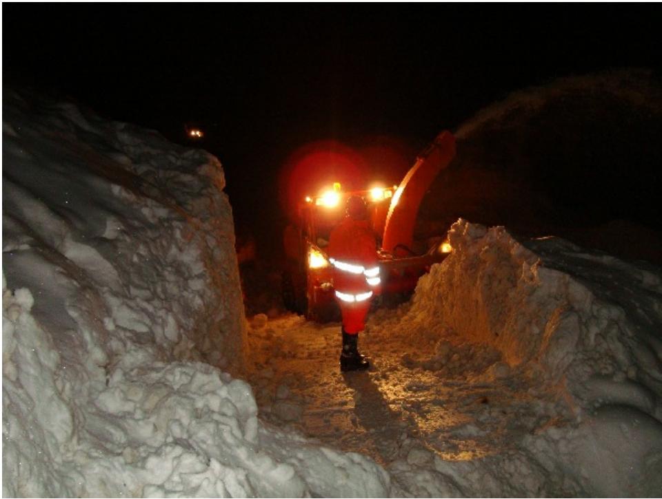
Abb. 9: Räumung der Lawinenablagerungen auf der Strasse bei Meien (UR). Zwischenzeitlich mussten die Räumarbeiten eingestellt werden, da weitere Schneemengen auf die Strasse nachzurutschen drohten (Foto: H.M. Henny, 10.01.2012).
