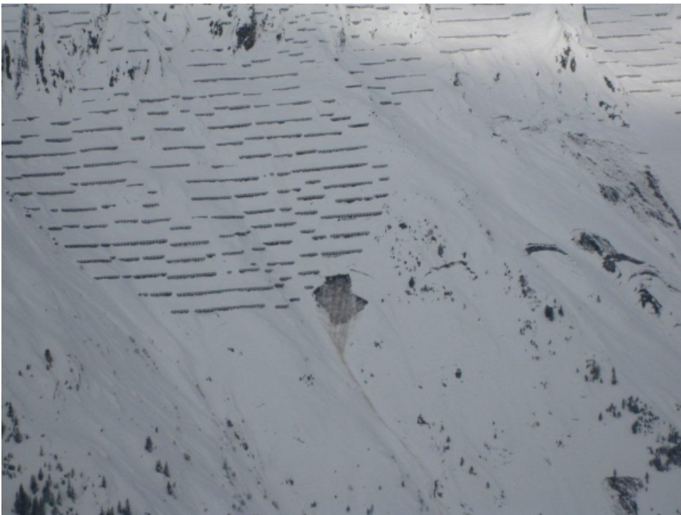
Die Lawinverbauungen oberhalb von Gurtellen, UR halten den vielen Schnee erfolgreich zurück. Darunter sind diverse ältere und eine frische Gleitschneelawinen und viele Gleitschneerisse zu sehen (Foto: T. Niffeler, 13.02.2012).
