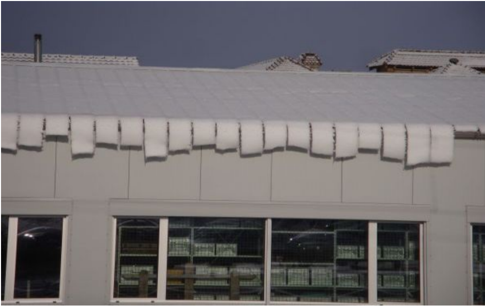
"Schneezauber". Schnee kann sich stark verformen, besonders wenn er warm ist und langsam belastet wird. Das Dach ist nach Süden orientiert, hat eine Neigung von ca. 20 Grad und ist mit Blechbahnen von ca. 50 cm Breite eingedeckt (Foto: H.U. Leuenberger, 09.02.2013).
